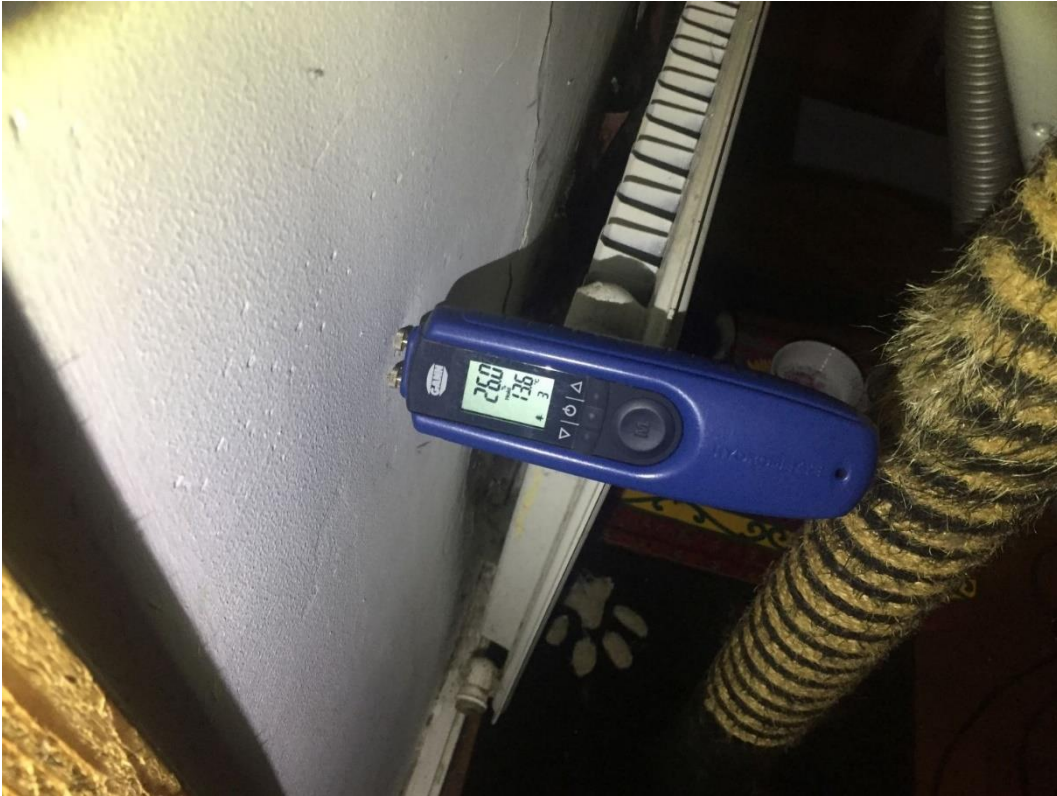
Kraftigt forhøjet fugtindhold i skillevæg, entre
