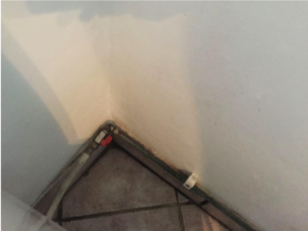
Skimmelbegroninger i ydervægshjørne, badeværelse
