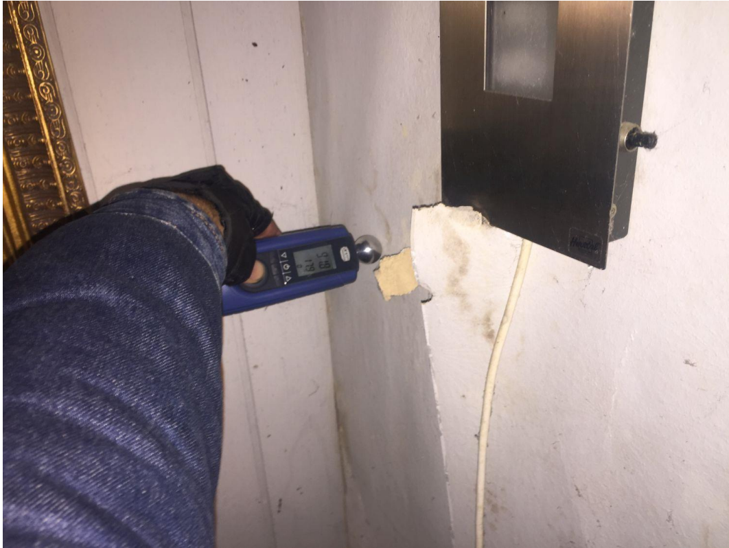
Kraftigt forhøjet fugtindhold i ydervæg, entre
