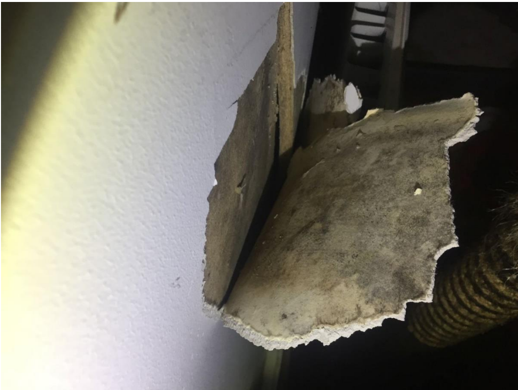
Skimmelbegroninger bag tapet på skillevæg, entre – Aftrykssted nr. 4
