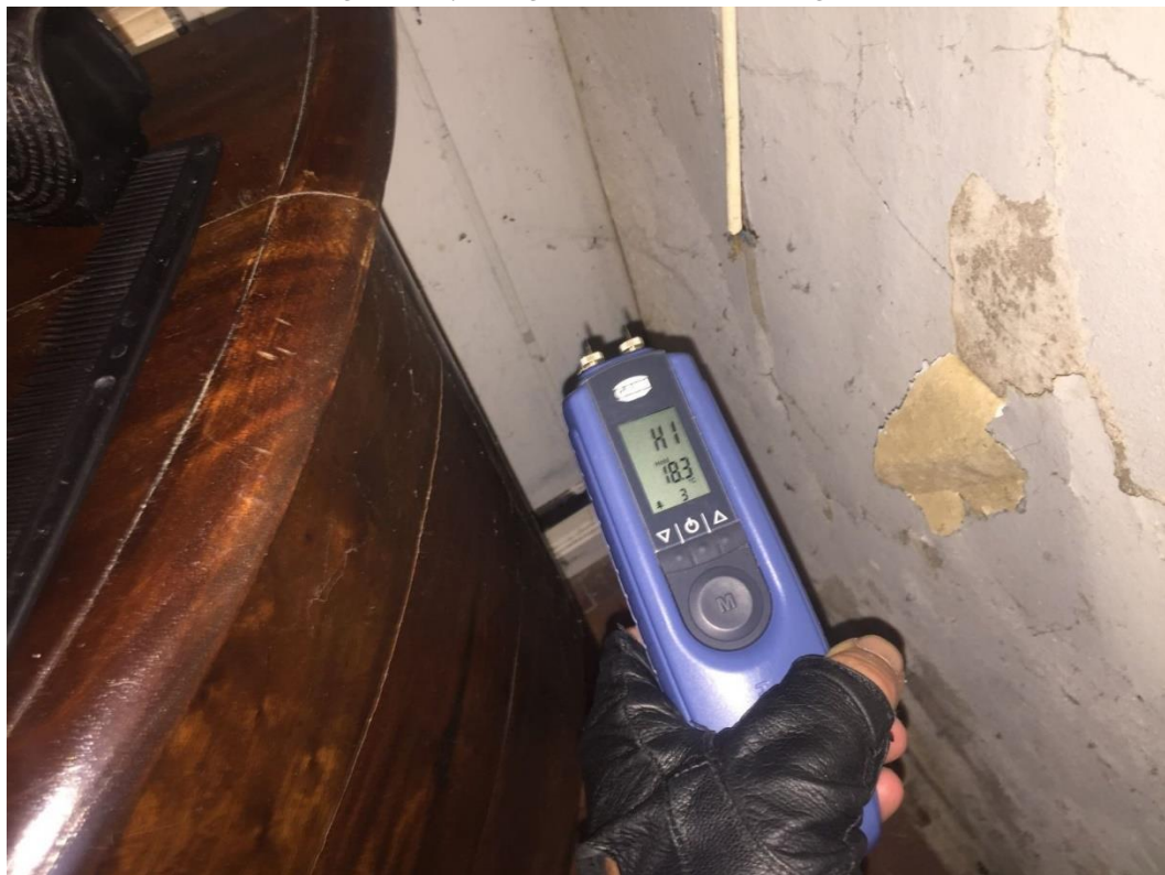
Kraftigt forhøjet fugtindhold i skillevæg, entre
