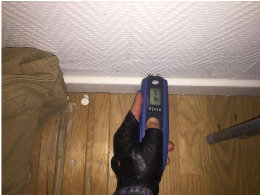
Skillevæg moderat opfugtet op til ca. 10 cm over gulvniveau, soveværelse
