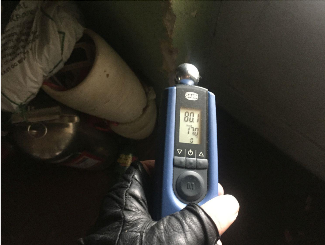
Ydervæg i bryggers kraftigt opfugtet
