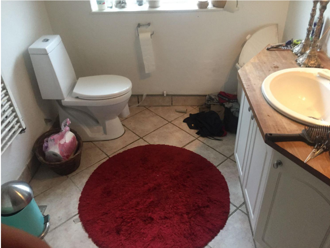
Varmekilde i badeværelse fungerer ikke
