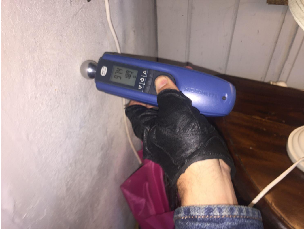
Kraftigt forhøjet fugtindhold i skillevæg, entre
