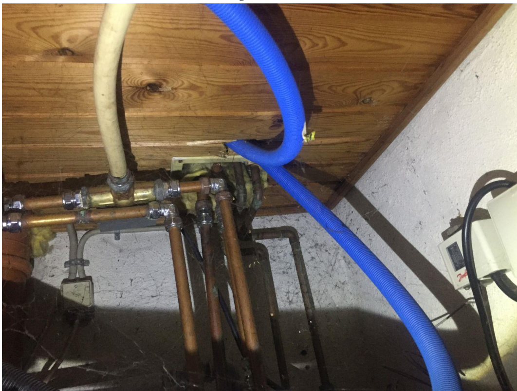
Flere områder med uforseglet mineraluldsisolering, bryggers
