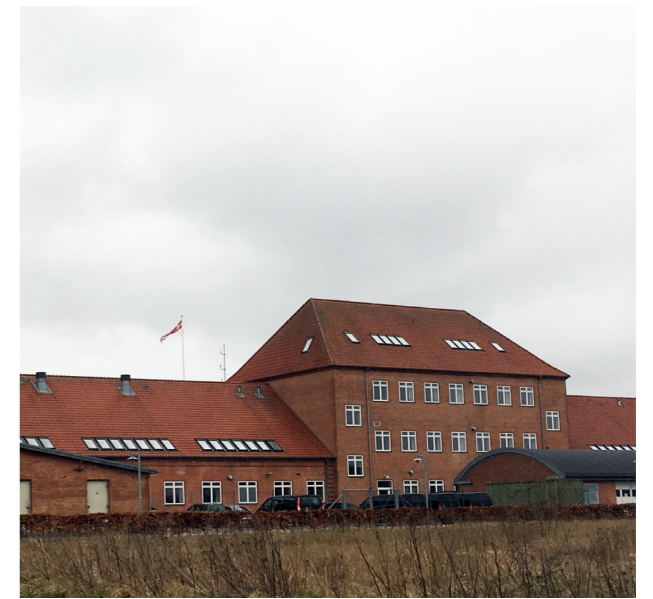
Forskydning i bygningskroppe i kasernen
