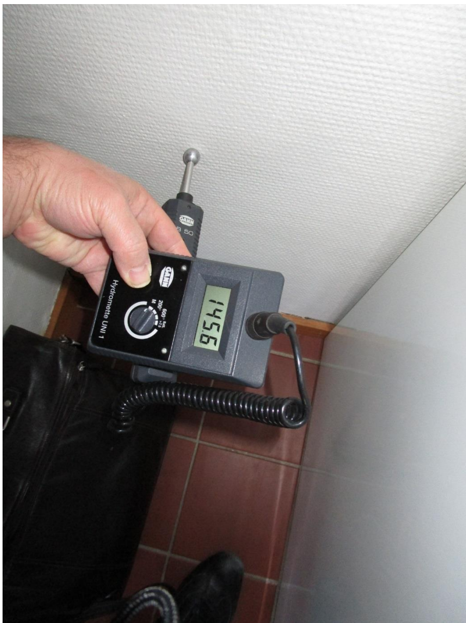
Stueetagen – køkkenet – stærkt forhøjet fugt i skillevæggen mod entreen (> 130 digts med Gann Hydromette UNI I)
