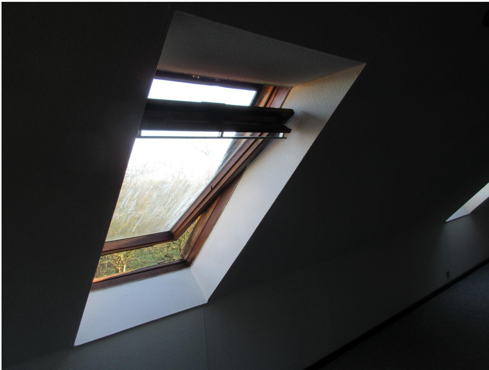
1 sal – soveværelset – ovenlysvindue kan ikke lukkes helt, og det kan kun åbnes ca. 10 cm
