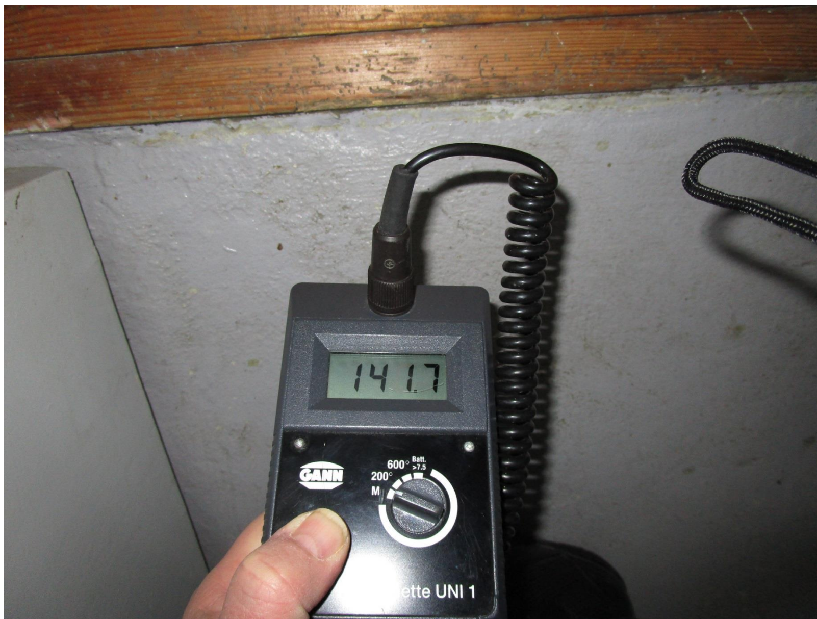
Stueetagen – bryggerset – forhøjet fugt i betongulvet (>130 digts med Gann Hydromette UNI I)
