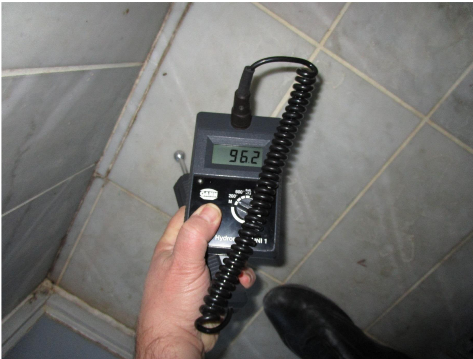
Stueetagen – badeværelset – synlig skimmel i flisefugerne – let forhøjet fugt i klinkegulvet (ca. 95 digits med Gann Hydromette UNI I)
