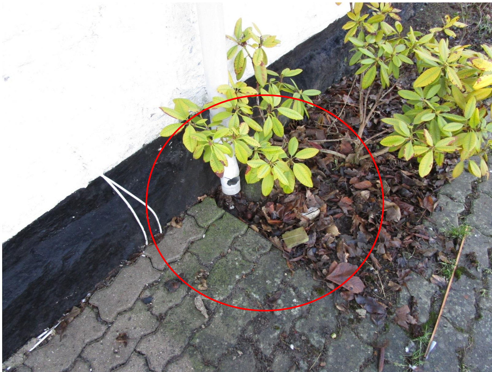
Tagnedløb mod haven er ikke sluttet på en brønd men afvander direkte på jorden
