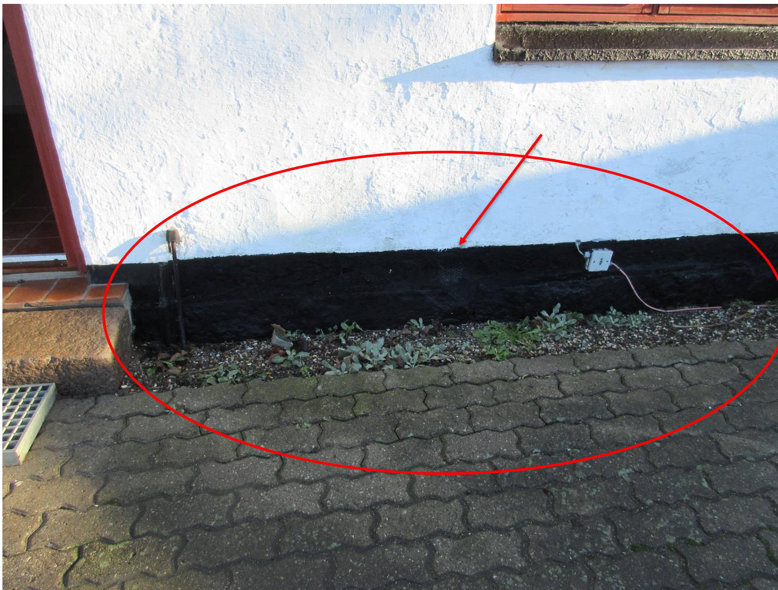
Kampestensokkel sortmalet til ca. 10 cm op på murværk – jord direkte mod sokkel – ventilationsrist til krybekælder er for lille og der er for få ventilationsriste
