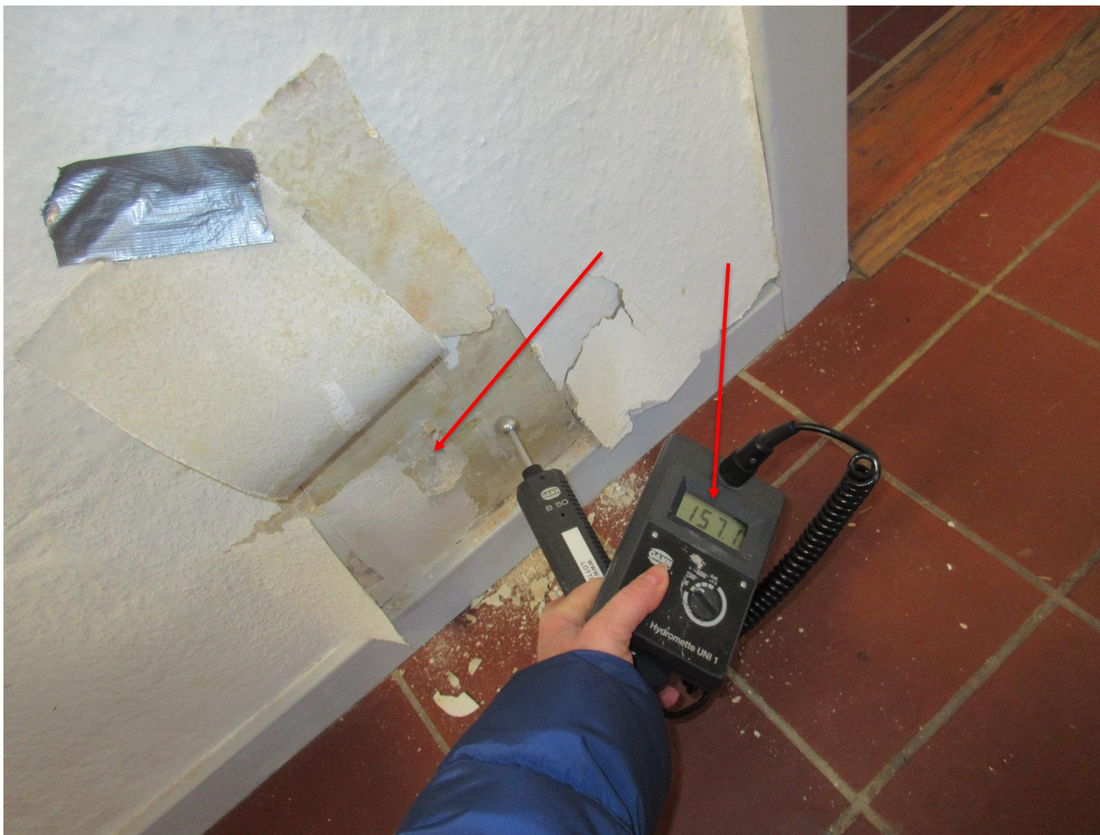
Stueetagen – entreen – stærkt forhøjet fugt i skilleveggen mod køkkenet – udtagning af pudsprøve til påvisning af skimmelvækst (>130 digts med Gann Hydromette UNI I)
