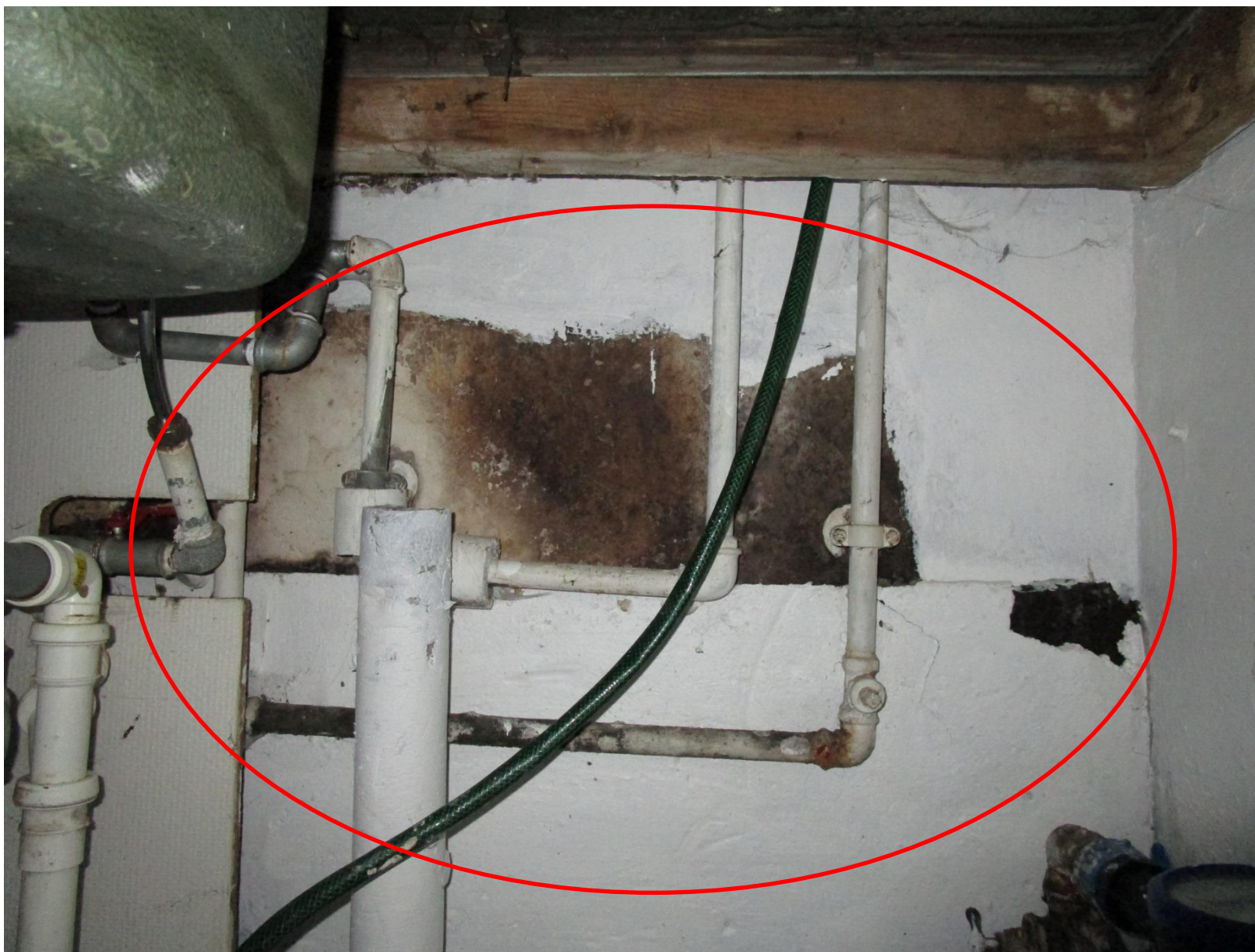
Stueetagen – bryggerset – synlig skimmel på ydervæg under håndvasken – der er monteret polystyren på væggen
