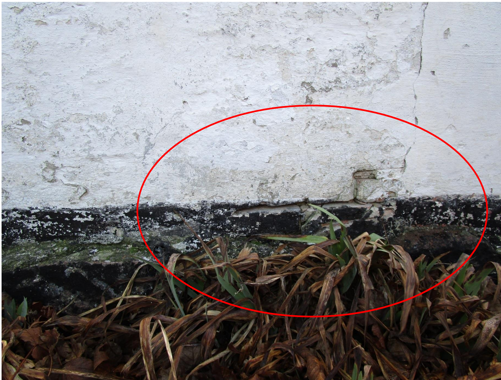
Manglende fugtspærre mellem sokkel og murværk
