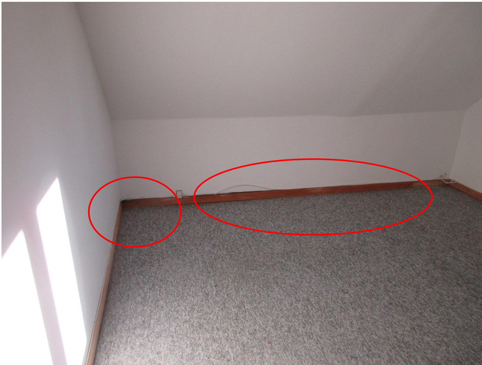
1 sal – værelset – synlig skimmelvækst på væggen og ved fodpanelet mod skunkrummet
