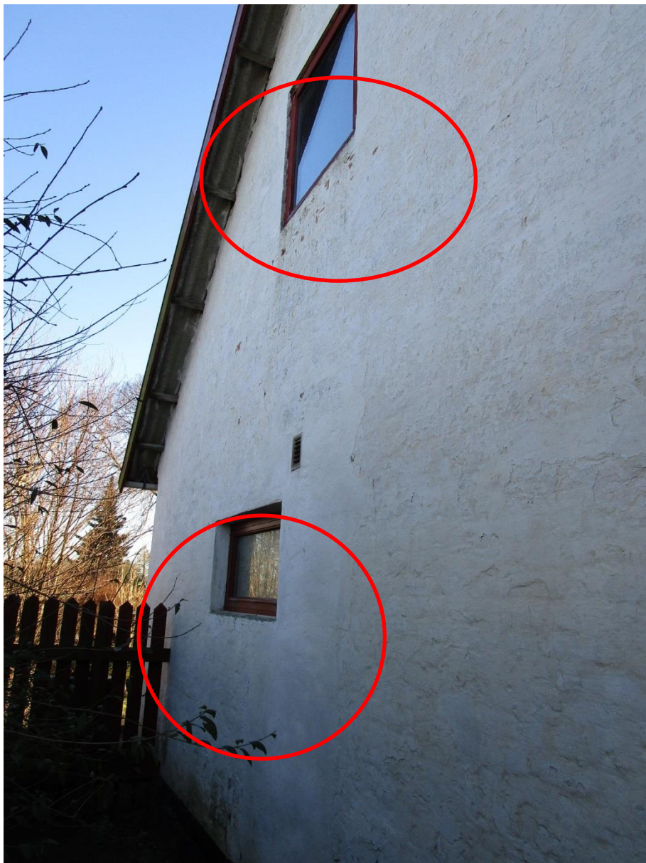
Gavlen mod Ringsted – der er ikke sålbænk under de 2 vinduer
