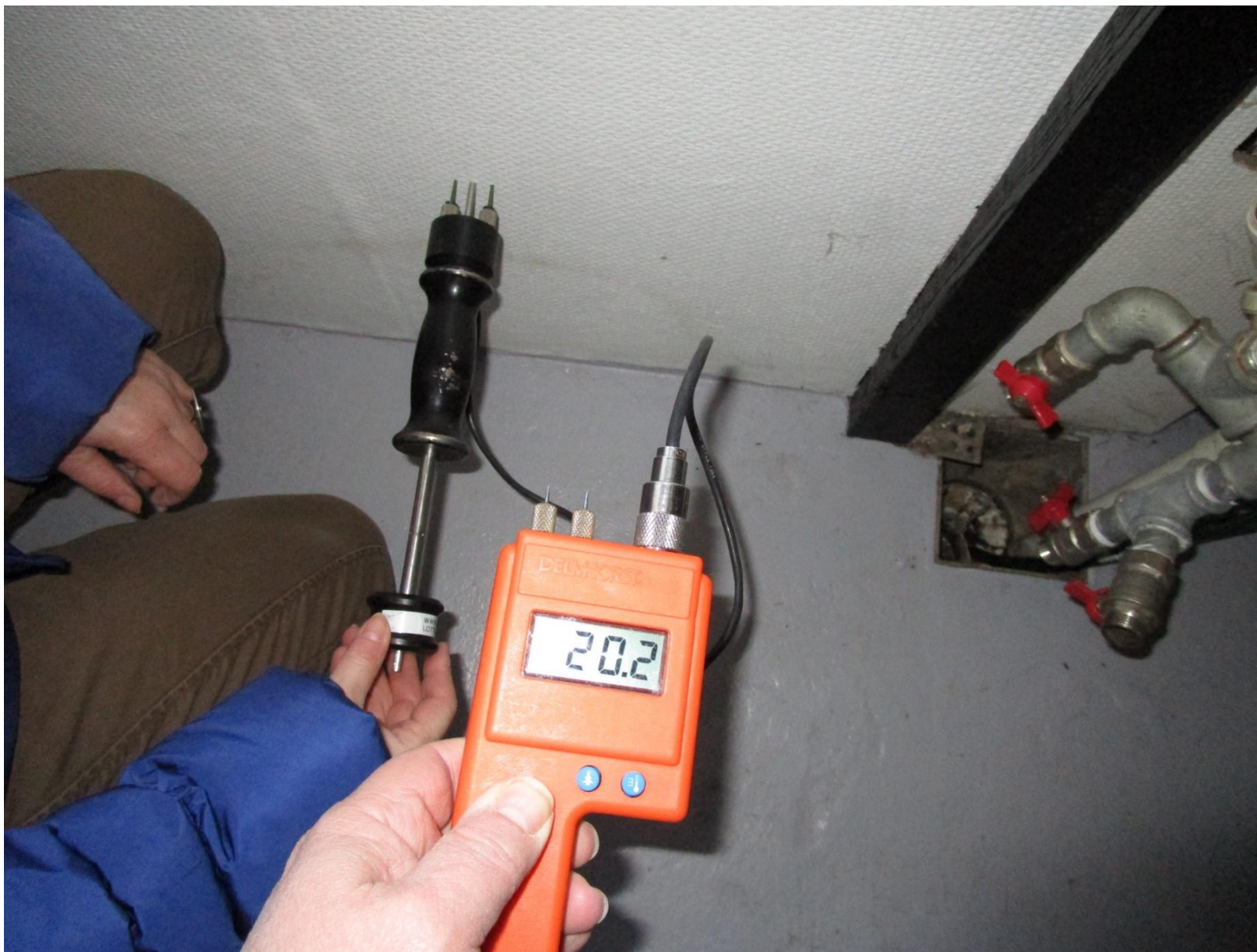
Stueetagen – bryggerset – forhøjet fugt i ydervæggen ved pladebeklædningen (RF% 20 med Delmhorst)
