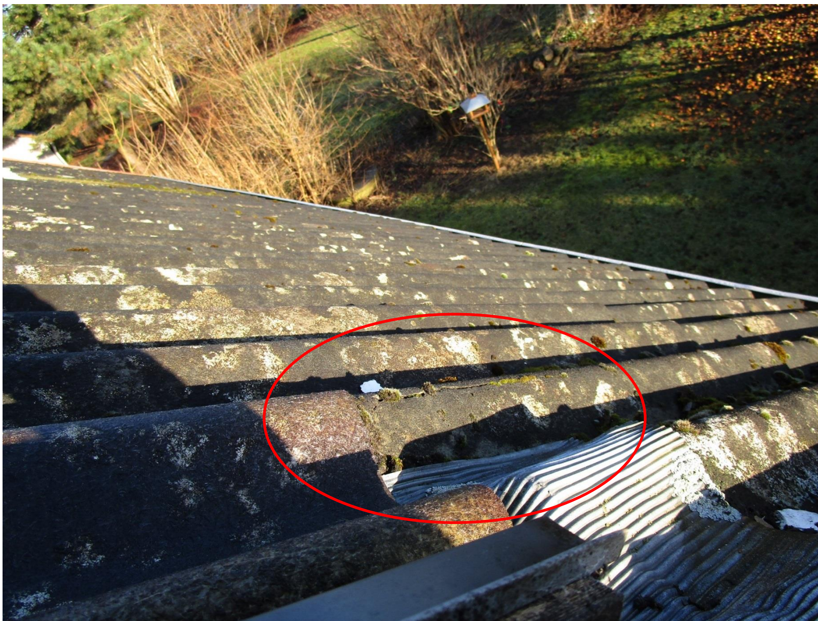
Asbesttaget fremstår meget slidt og med revner
