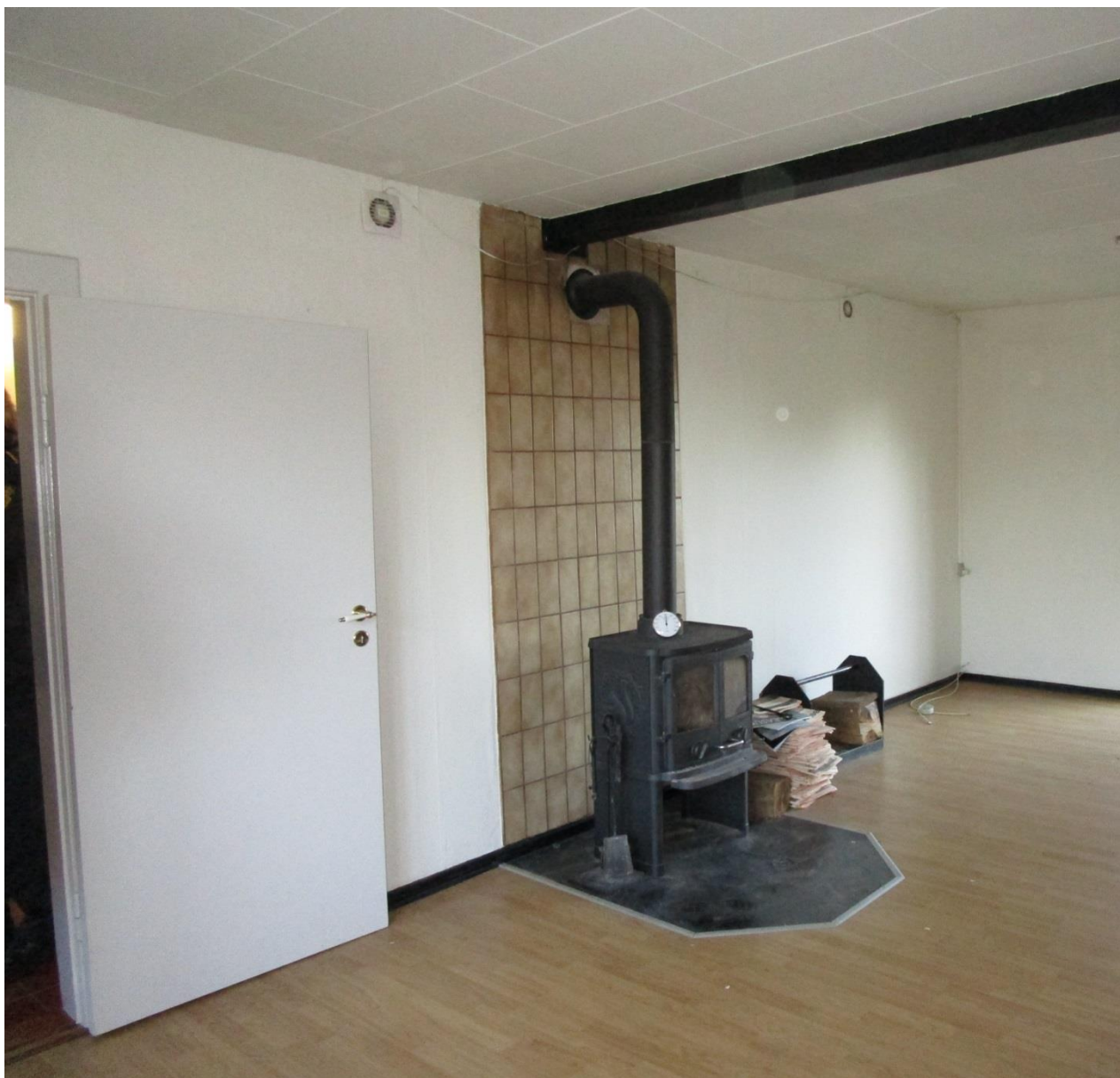
Stueetagen – stuen – brændeovn Morsø 2140 til opvarmning af stueetagen
