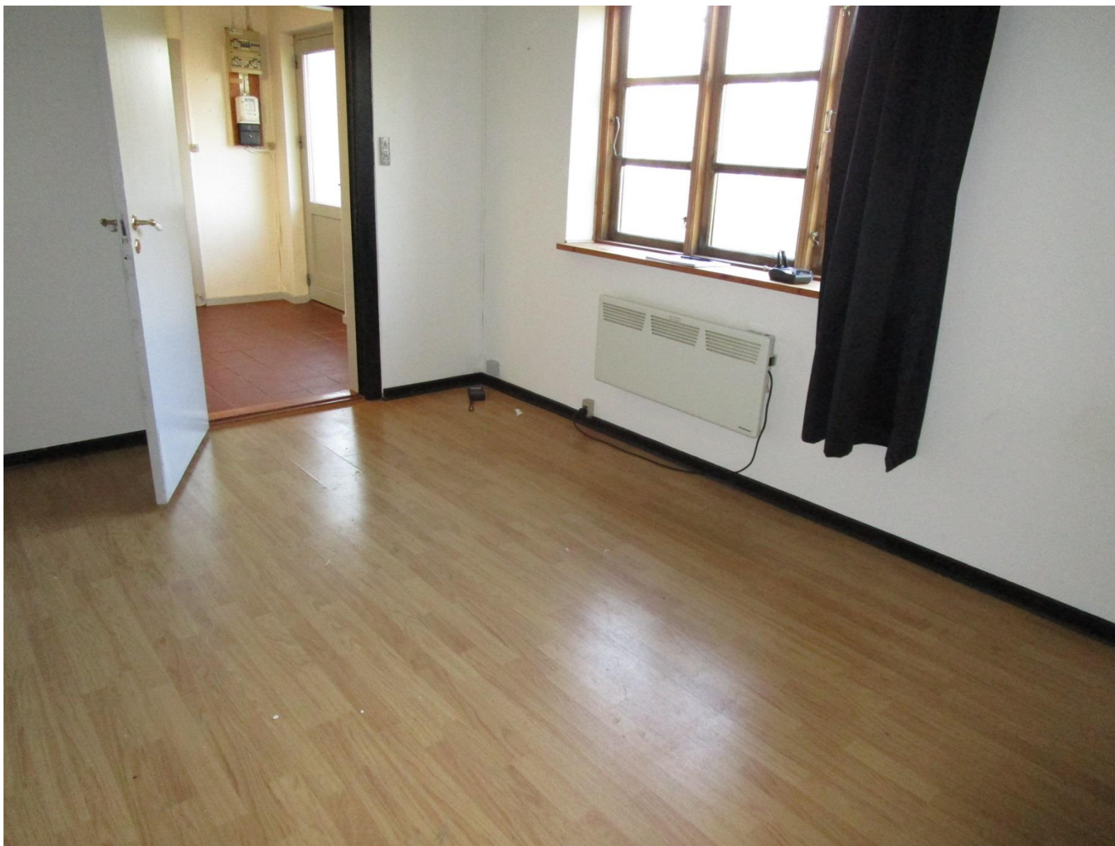
Stueetagen – værelset – el-radiator til opvarmning af værelset – let forhøjet fugt i gulvet mod entreen
