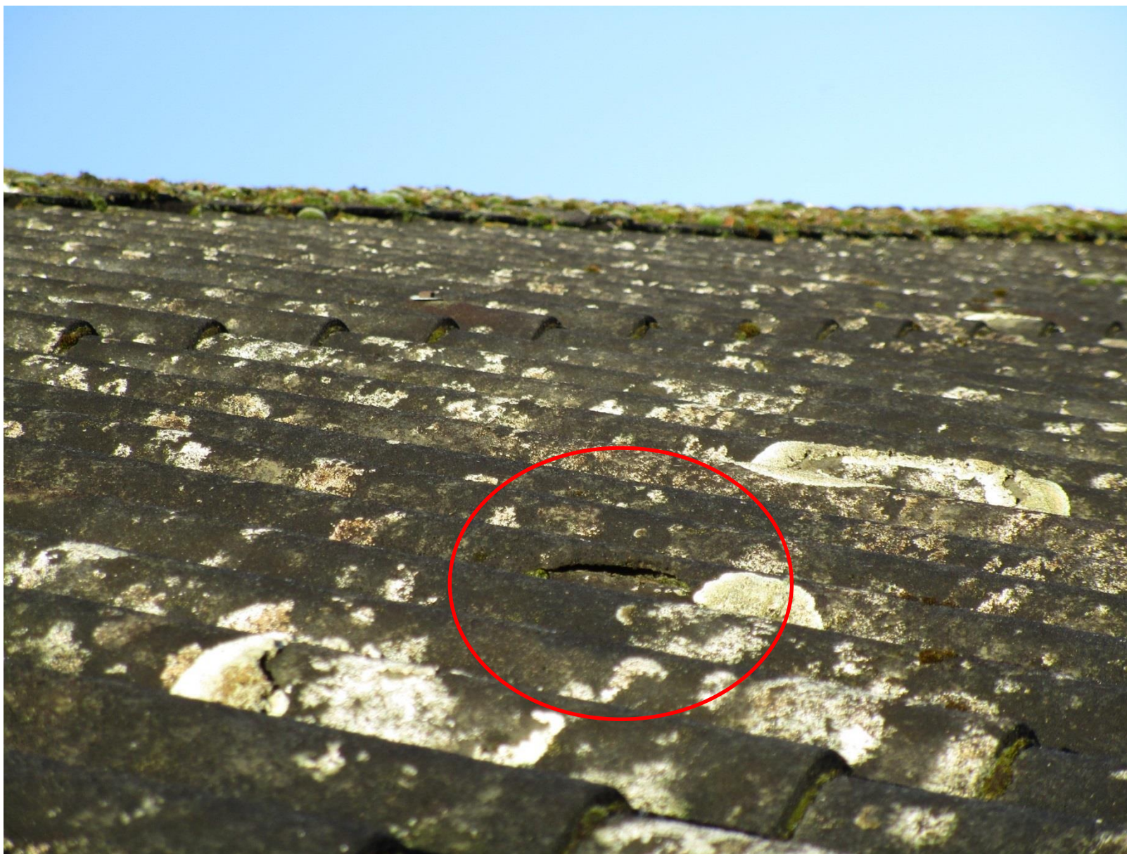
Asbesttaget fremstår meget slidt og med huller
