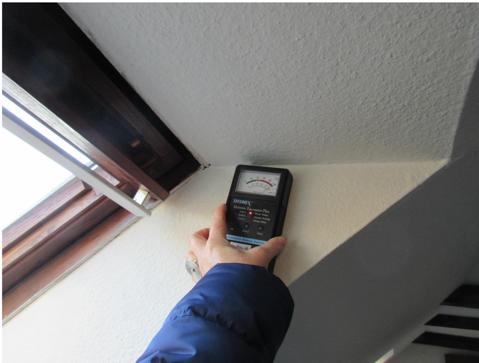
1 sal – soveværelset – stærkt forhøjet fugt i lysning ved ovenlysvinduet (RV 28 med Tramex)
