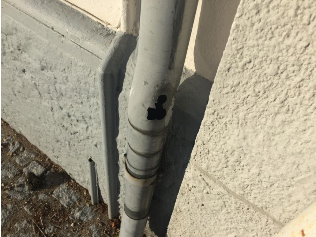
Utæthed i tagnedløb ved tilstødende nabobygning
