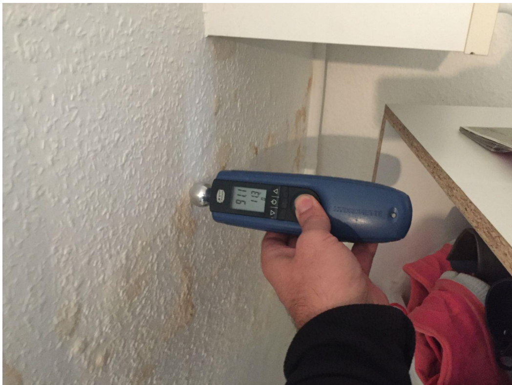
Kraftigt forhøjet fugtindhold i skillevæg, entre
