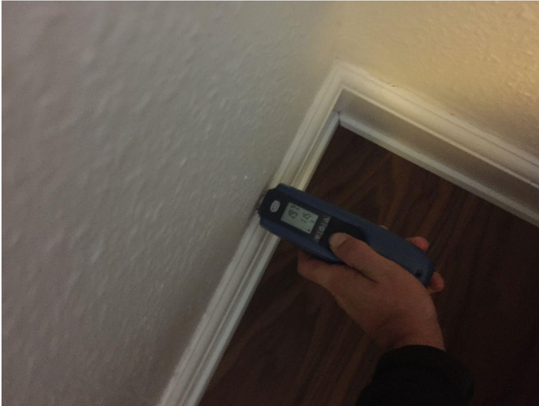
Kraftigt forhøjet fugtindhold i ydervæg, soveværelse
