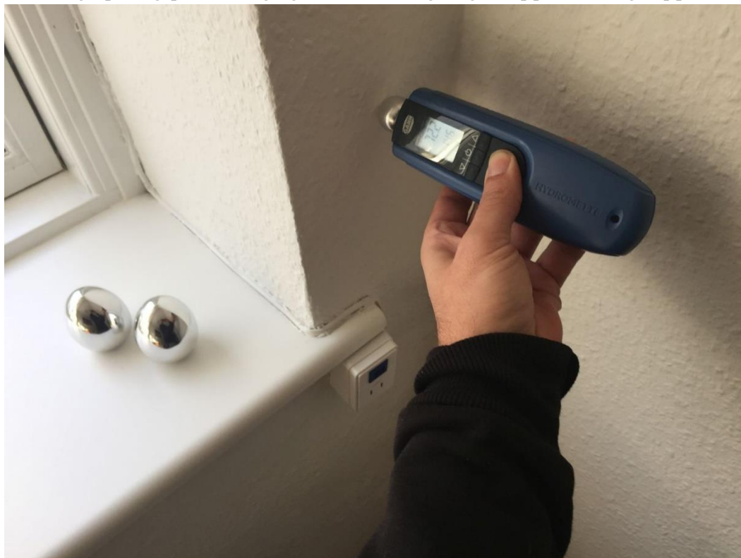
Kraftigt forhøjet fugtindhold, ydervæg, stue
