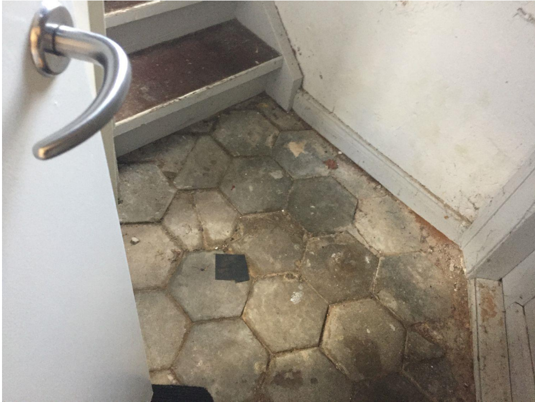
Tegn på fugtpåvirkning og vandindtrængning i trapperum, bagtrappe
