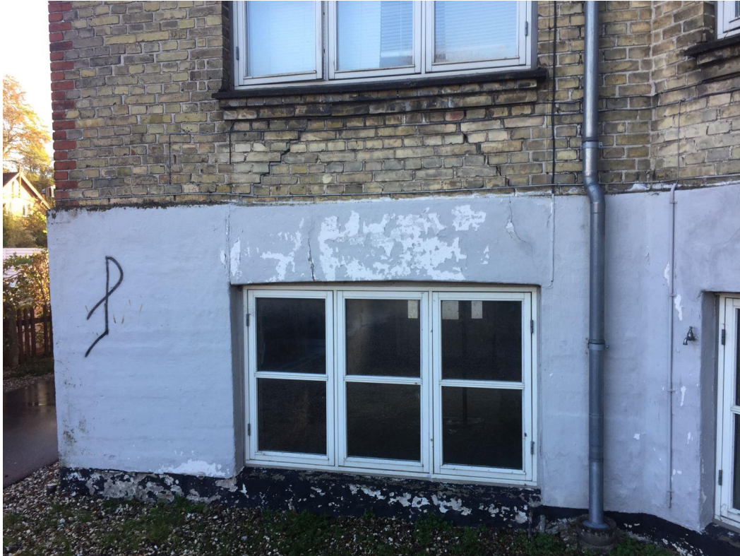
Kraftige afskalninger i murværk og sokkel
