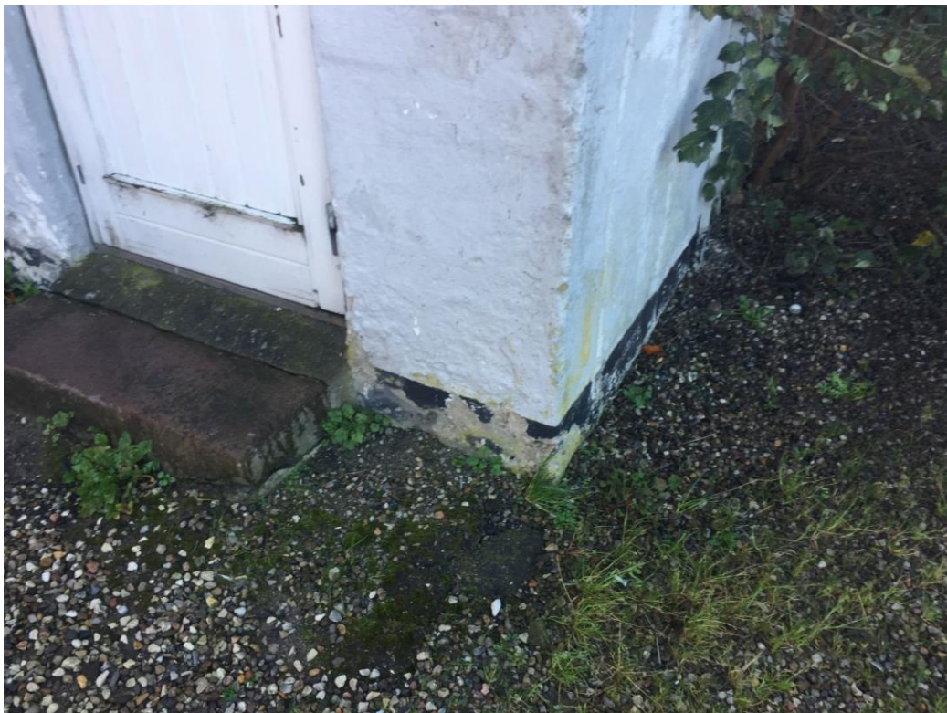
Kraftige afskalninger i murværk og sokkel
