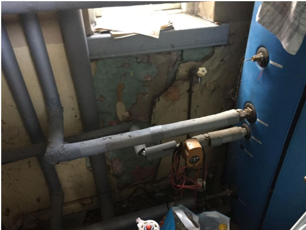
Afskalninger i ydervæg i trapperum, bagtrappe
