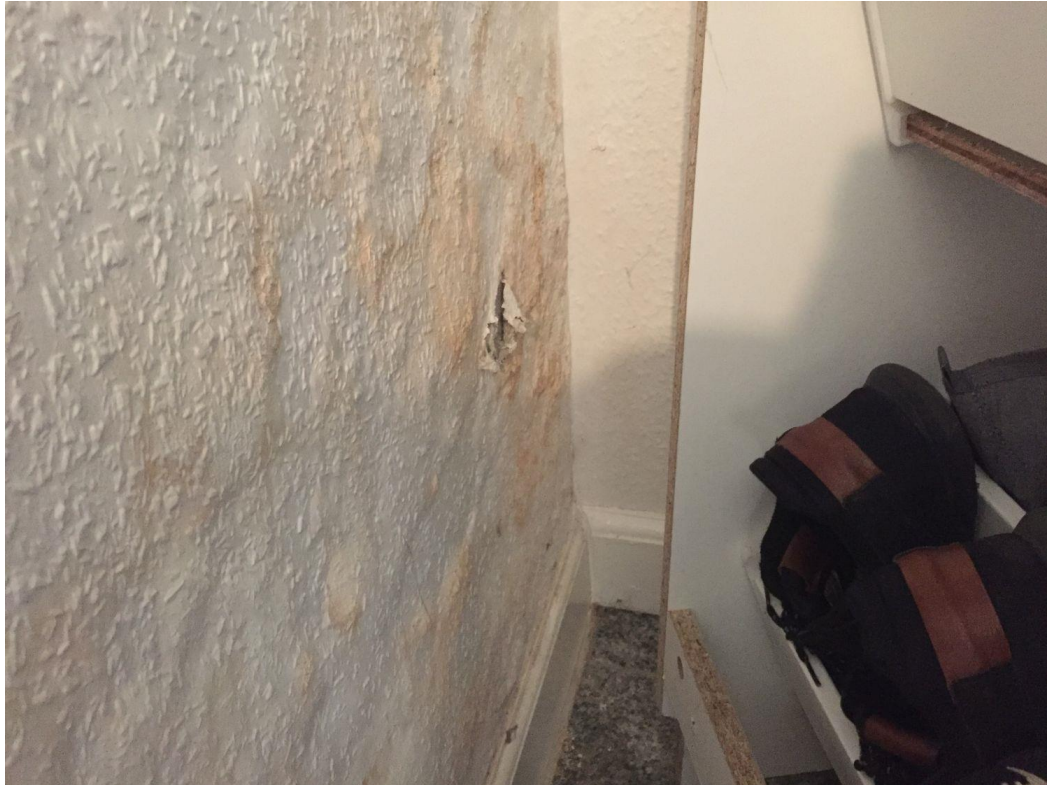
Skimmelvækst på skillevæg, entre – Aftrykssted nr. 2
