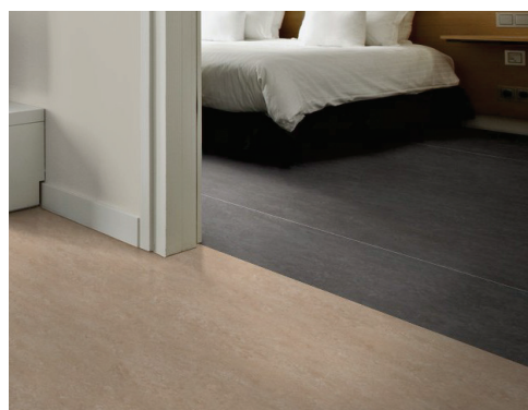
Gulve: Generelt i linoleum, udvalgte steder arbejdes med et farveskift imellem rummene.
