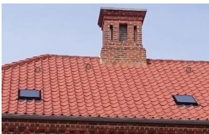
Eksempel på en teknisk installation integreret i en skorsten for ikke at bryde med bygningens udtryk
