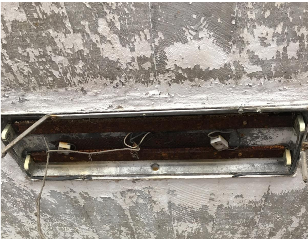
Billede 2 – Besigtigelse den 18. september - Lysarmatur ødelagt, ledninger hænger løst ned..
