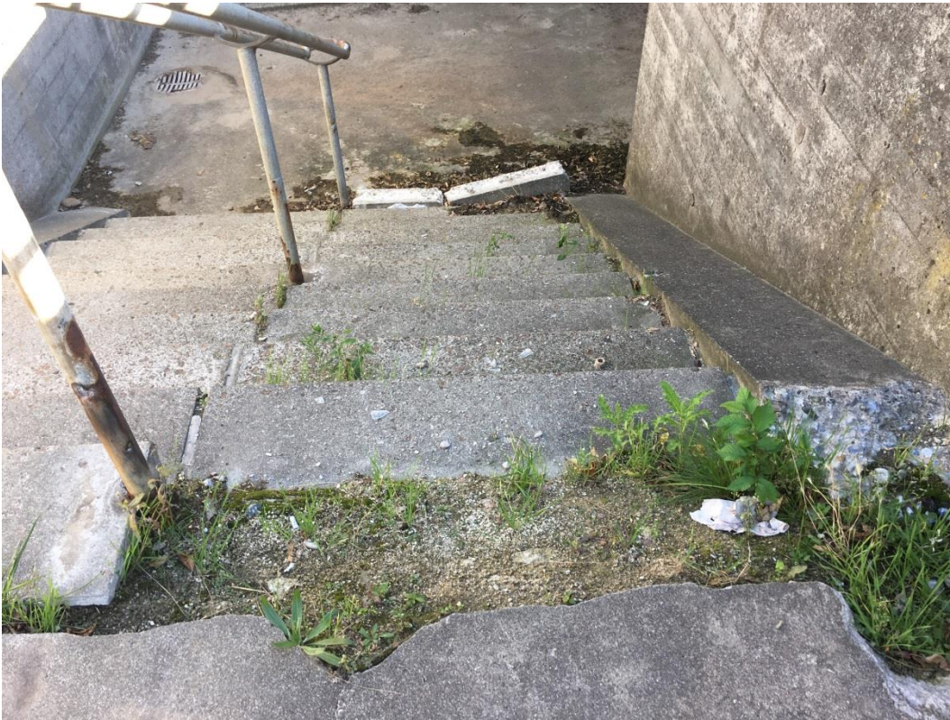
Billede 1 – Besigtigelse den 18. september - Trappetrin slået løs, ligger for enden af trappen.
