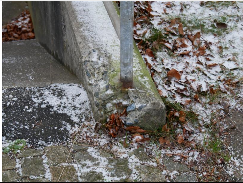
Afskaldning af beton.
