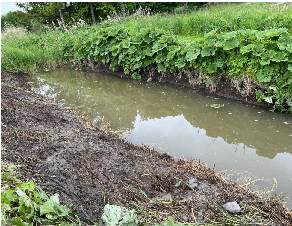
Figur 19 Sandfang 2, nær Farendløsevej
