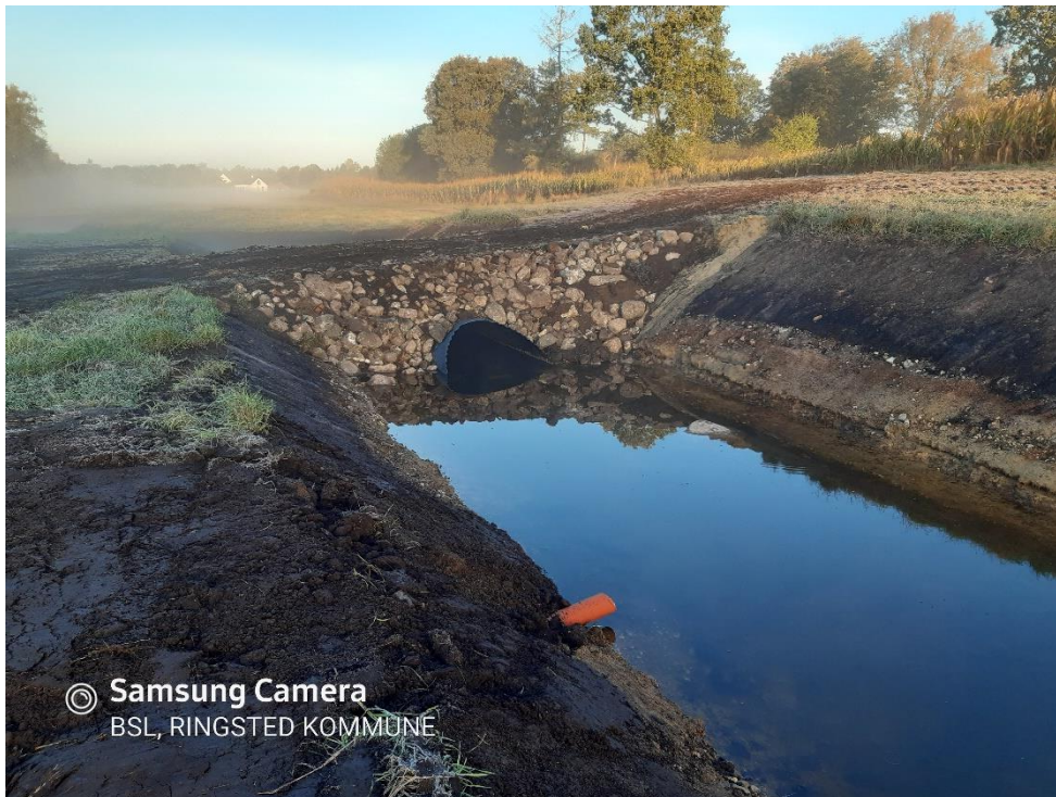
Figur 11. Etableret rørbro, samt ét af to forlængede drænudløb, på matr 9i
