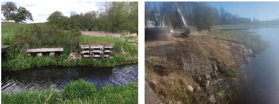
Figur 39 pumpestation før (tv) og efter (th) fjernelse af løse dele og jernbanesveller
