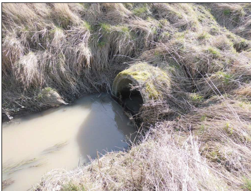
Figur 4.4.: Rørgennemløb med sætning, st. 1.591-1.597 meter
