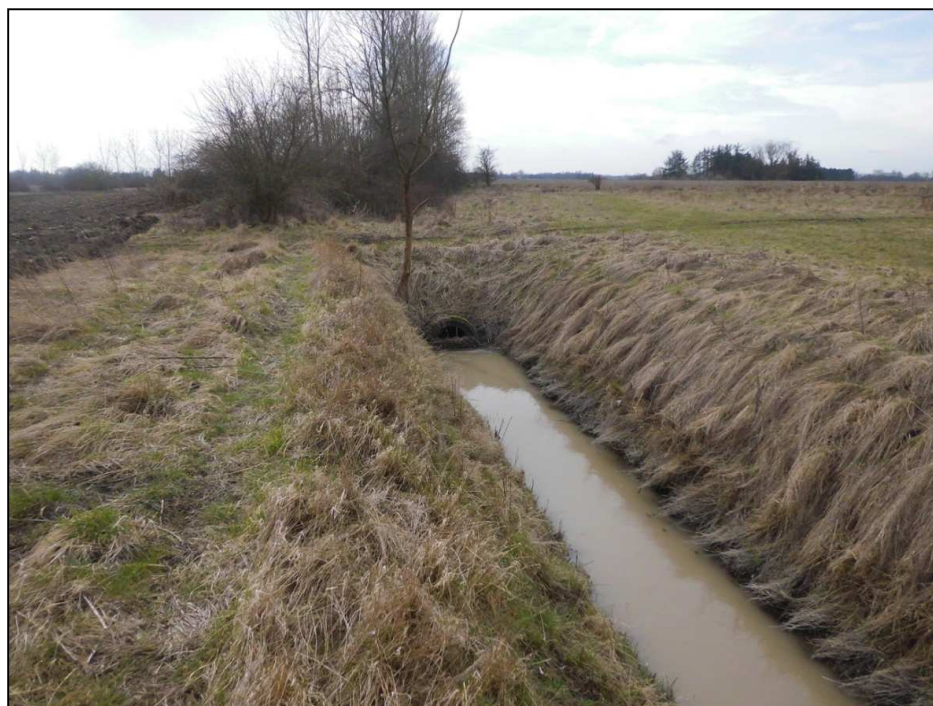
Figur 4.6.: Ophobning af materiale ved rørgennemløb
