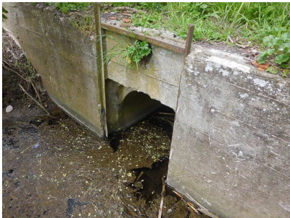
Figur 4.9.: Udløbet fra pumpebassinet kan reguleres med et stigbord
