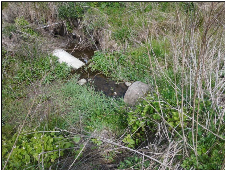
Figur 4.6.: Rørudløb, inaktivt rørelement til venstre.
