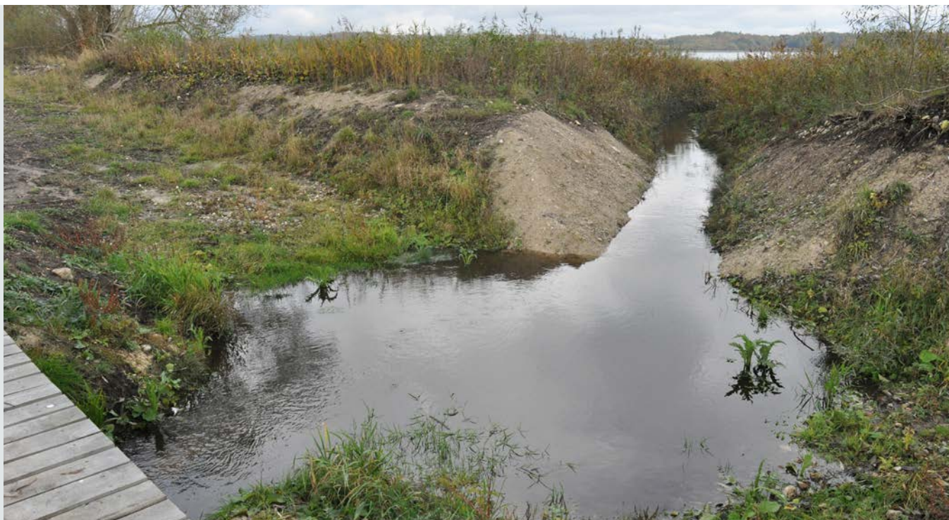
Flæbækken er ført gennem dæmningen direkte ud i søen. Der er lavet et vadested ved siden af broen.
