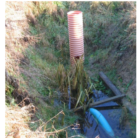
Ulovligt nedlagte rørledninger i vandløb
